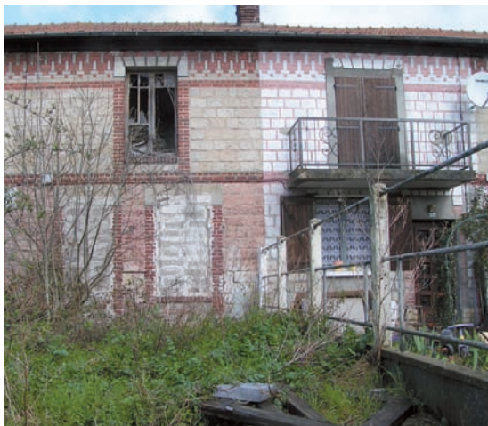
Des maisons habitées jouxtent des ruines, une situation dangereuse.
