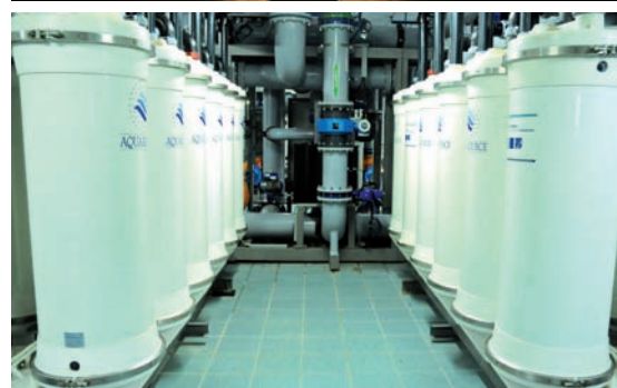
L'usine de traitement de la Jatte, à Rouen, dispose de techniques d'ultrafiltration pour garantir la qualité de l'eau. En haut : Le Robec en sous-sol.
