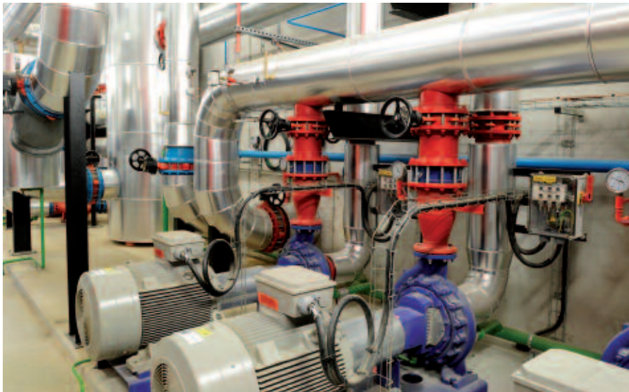
En haut, les tuyaux d'eau à la sortie des chaudières. À droite, le filtre qui absorbe les plus fines particules. En bas, les pompes qui envoient l'eau chaude dans le réseau.
