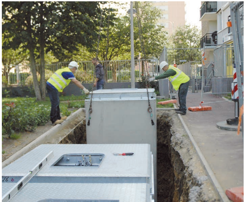
Les conteneurs enterrés permettent de limiter les nuisances sonores et olfactives.
