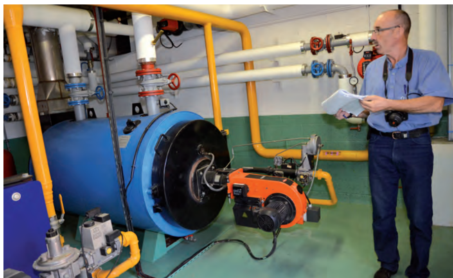
La nouvelle gestion du chauffage a mis au jour différentes faiblesses du réseau, parfois difficiles à résoudre.
