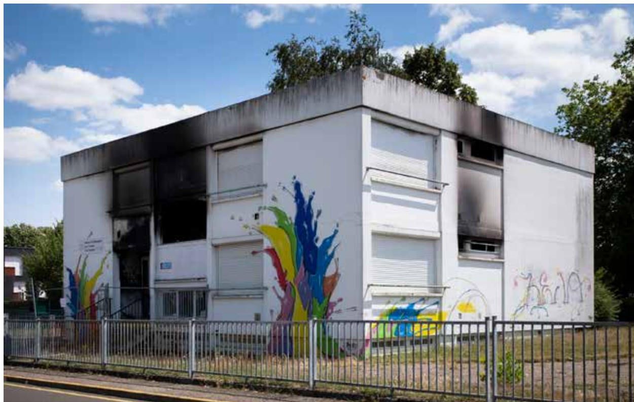
◀ La Mief a été le bâtiment le plus durement touché.
